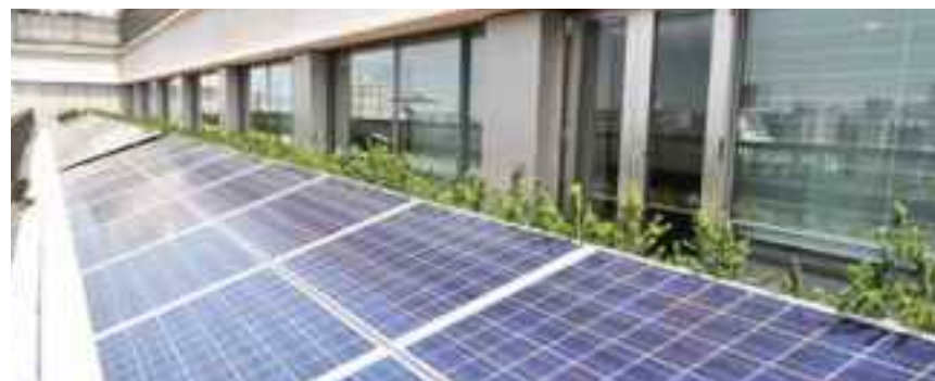
E棟12階に設置された太陽光パネル。日中発電する太陽光パネルは、昼間に電気を多く使う学校には適した設備です。
